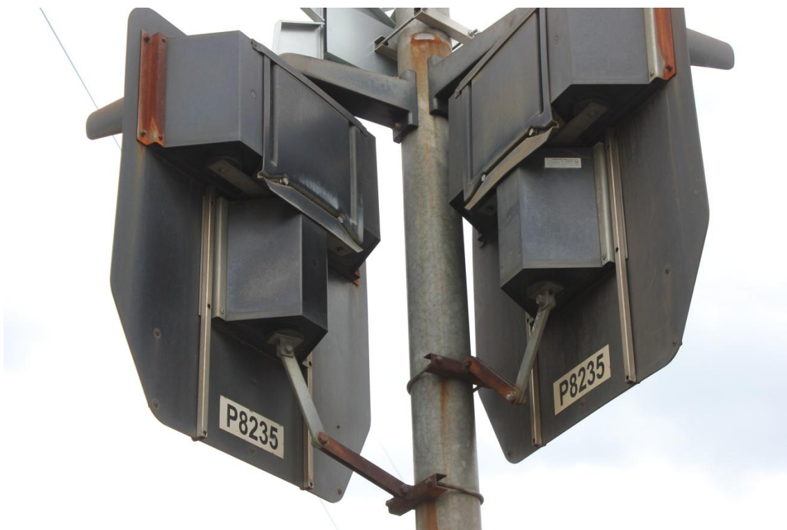
Obrázek 6 Značení železničního přejezdu
