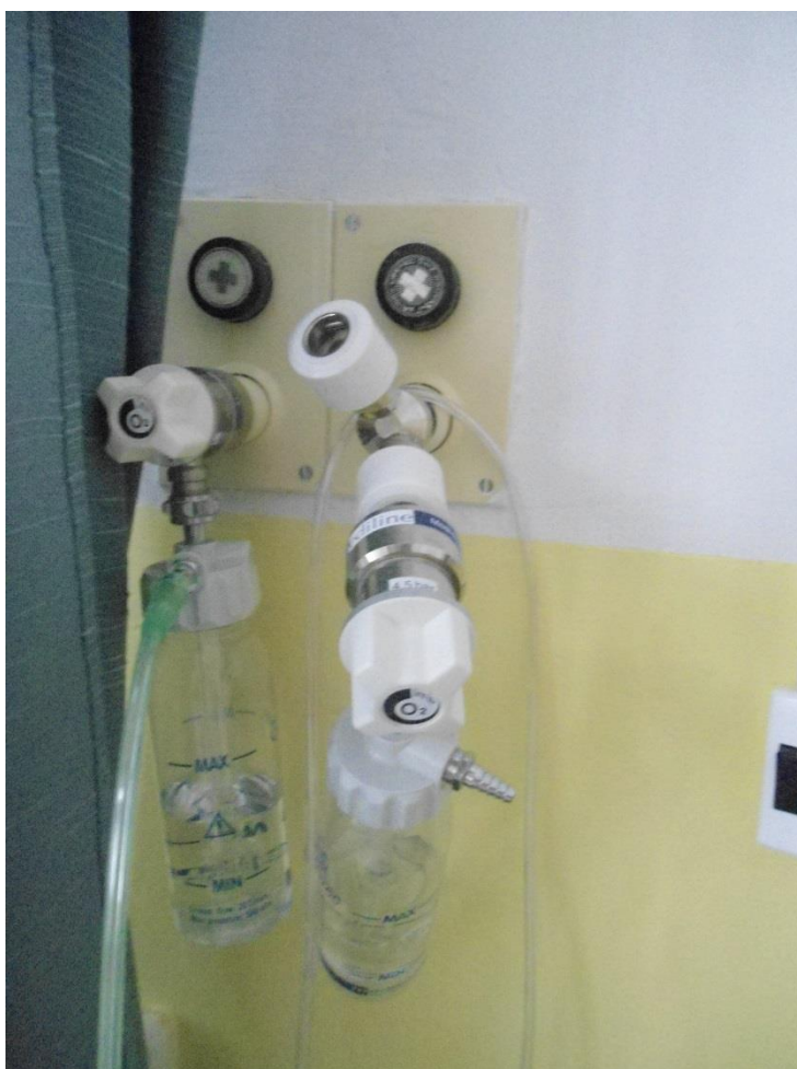
Obrázek 1 Centrální rozvod kyslíku
