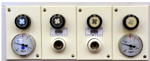
Obr. 16-1 Panel centrálního rozvodu kyslíku (hlavní uzávěr kyslíku je označen bílým středem – vpravo)
