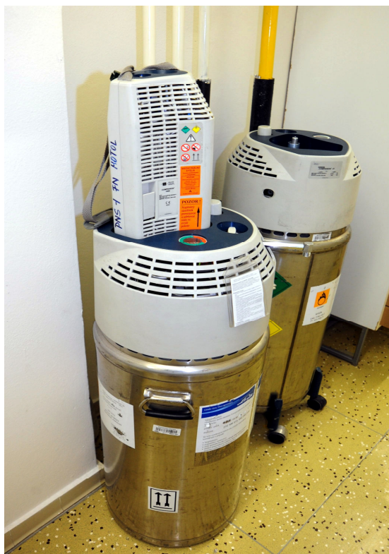
Obr. 16-4: Systém s kapalným kyslíkem – plnění přenosného zásobníku ze stacionární nádoby
